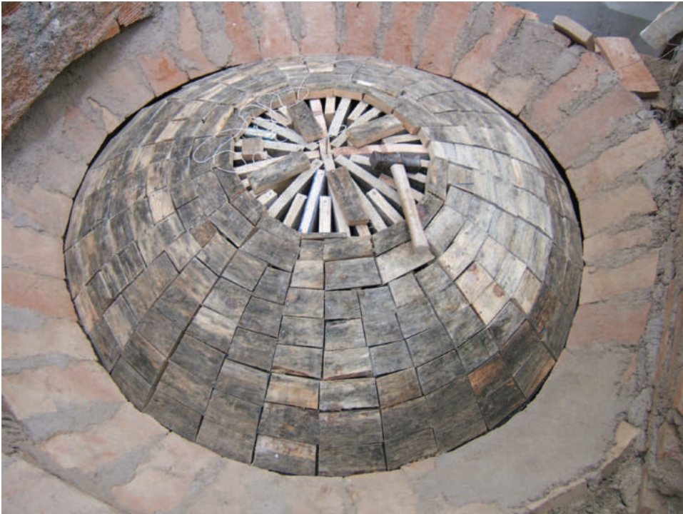
Lám. 9. Proceso de reconstrucción de una de las cúpulas del baño. Foto: Francisco Ibáñez.
