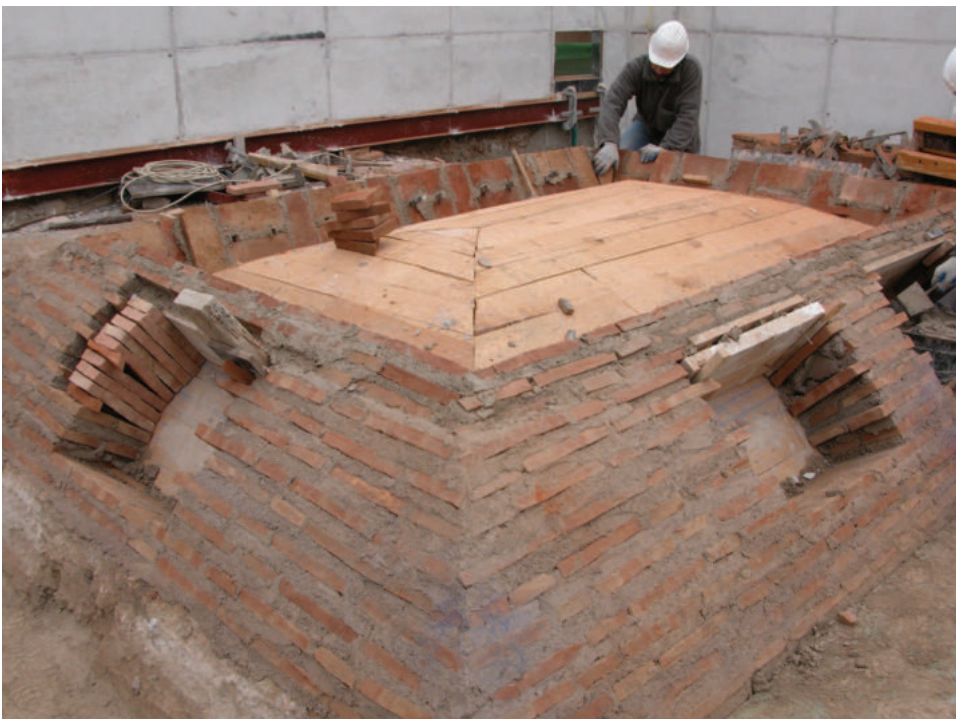
Lám. 10. Labores de reconstrucción de una de las bóvedas del baño. Foto: Francisco Ibáñez.
