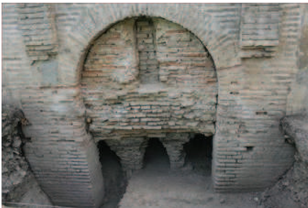
Lám. 21. Ejemplo de cerramiento y de hipocausto. Baños de La Zubia 20 . Foto: M. a Reyes Ávila Morales.
