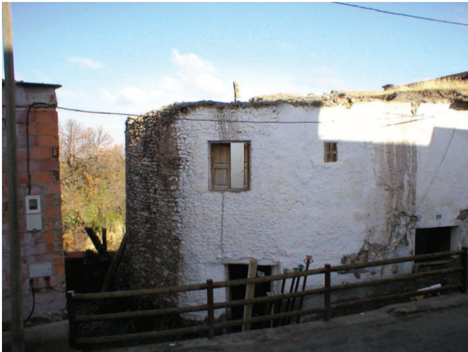
Lám. 1. Vista de la fachada S de la vivienda que envuelve el baño
