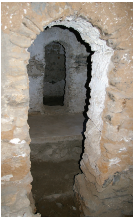
Lám. 10. Detalle de los vanos interiores del baño (vista oeste-este). En la imagen se puede apreciar cómo no están directamente enfrentados. Foto: José Javier Álvarez.
