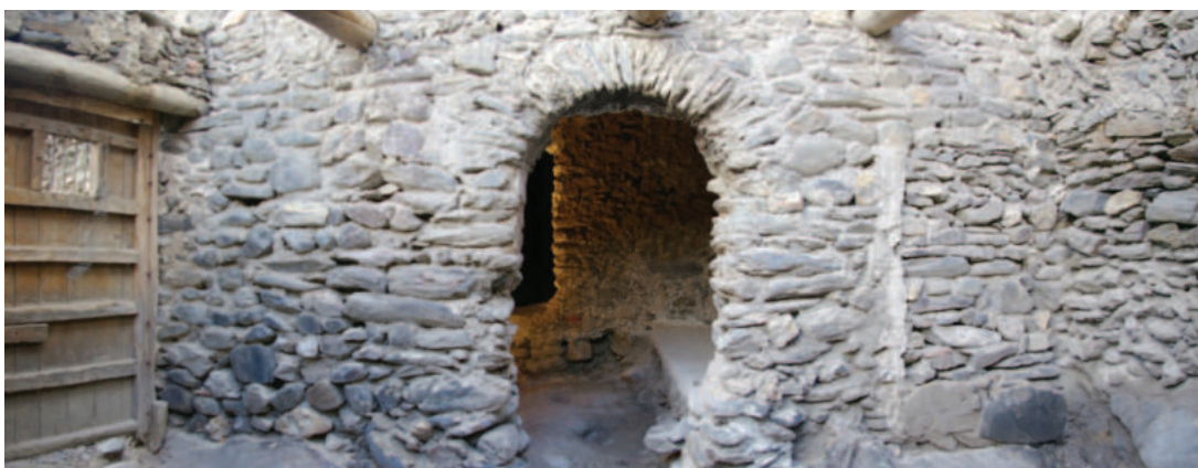
Lám. 27. Frente oeste del baño tras la intervención. Foto: José Javier Álvarez.
