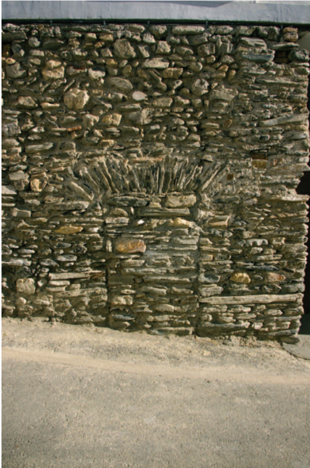
Lám. 21. Perfil de ubicación del vano para la caldera, que se ha tapiado para preservar el interior. Posteriormente sirvió de entrada a la cárcel de la villa.
