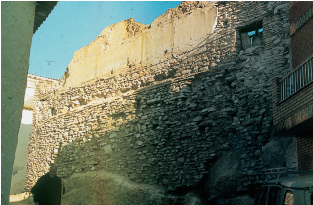
Lám. 5. Muro arruinado de la mezquita y/o iglesia vieja de Dólar.
