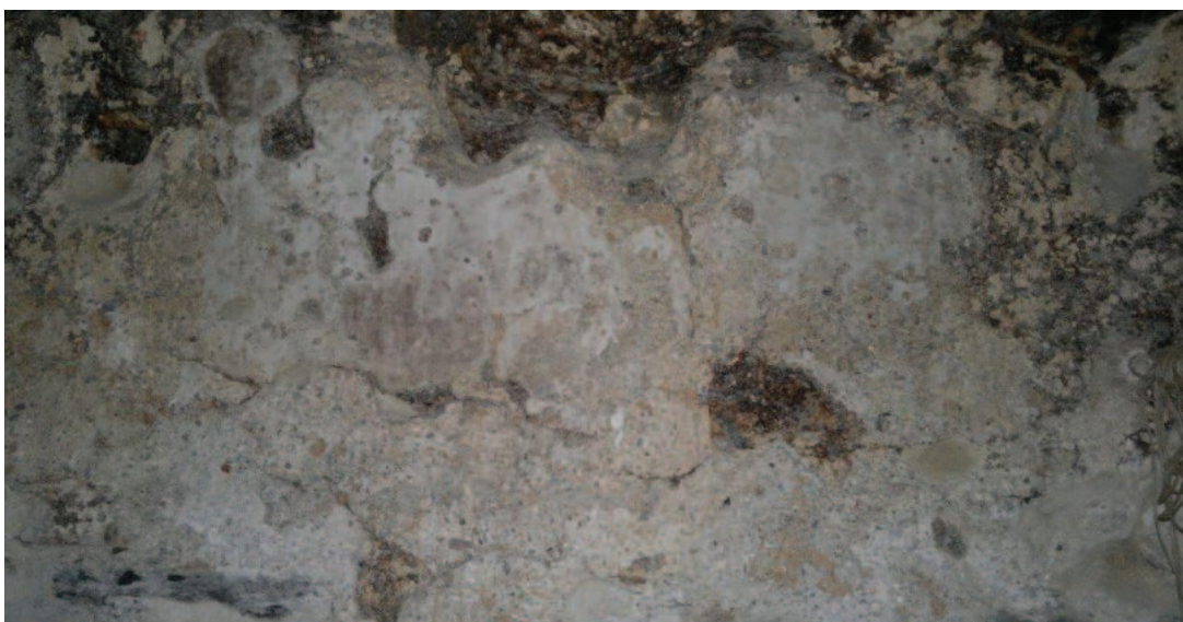
Lám. 2. Uno de los escasos restos de la capa de mortero de cal que quedan en los muros del baño. Foto: los autores.
