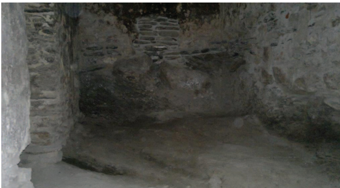
Lám. 1. Muros de mampostería de la sala fría, apoyados sobre la roca natural. Foto: los autores.
