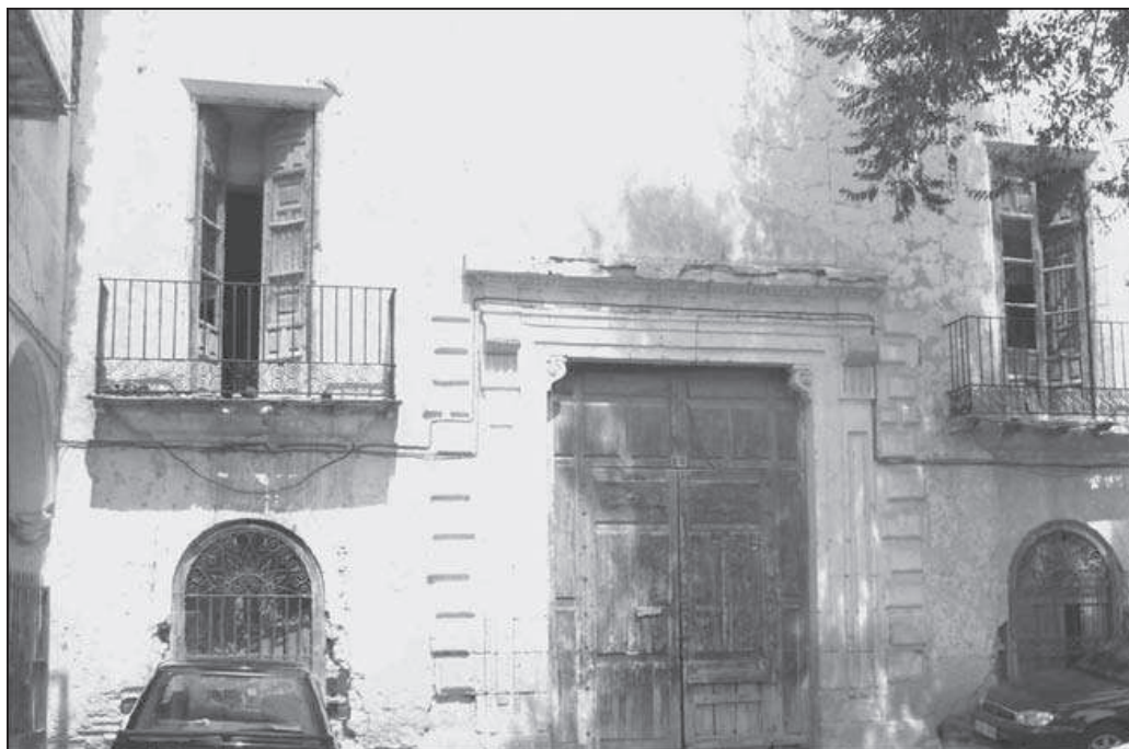
Estado actual de la fachada y puerta de acceso al Teatro Oscense.
