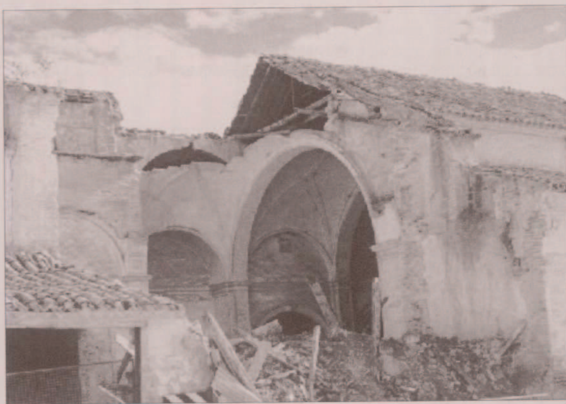
Capilla mayor de la iglesia de San Francisco tras su derrumbe en octubre de 1999.
