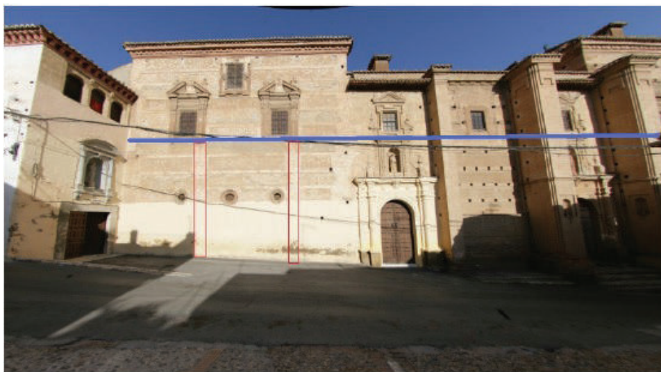
Fig. 22. Fachada del convento de la Concepción. La línea horizontal marca la altura a la que llegaría el edificio en el siglo XVI. Las líneas verticales marcan los machones de ladrillo que sólo llegan a los 8 m de altura. Fotografía: Javier del Pozo.
