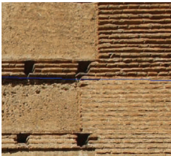
Fig. 23. Diferencia en el yagueado en los ladrillos entre el primer muro y el recrecido del XVII. Fotografía: Javier del Pozo.
