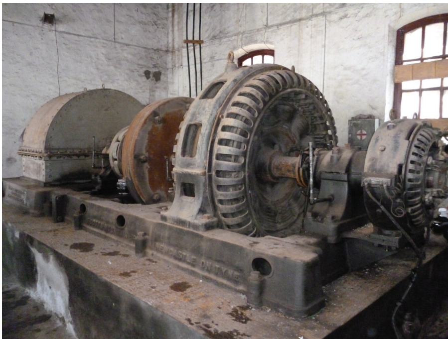
Lám. 16. Turbina Pelton, generador síncrono y excitatriz de la central de Alhorí I. Estado en el que se encuentra actualmente. Foto: del autor.
