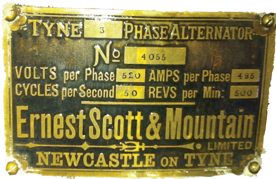
Lám. 5. Placa de características del generador de la central hidroeléctrica Alhorí I. Foto: del autor.
