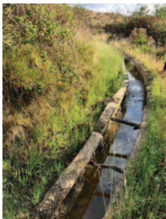
Lám. 18. Tramo de la acequia donde parte del muro está cediendo. Foto: Clara Fernández Berjón.
